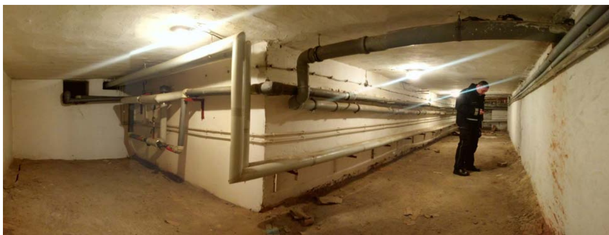
Foto.12 Podpiwniczenie - instalacja sanitarna i C.O.
