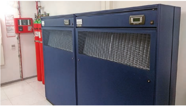
System wysoko wydajnej redundantnej klimatyzacji punktowej oraz system PPOż oparty na technologii gazowego czynnika gaśniczego INERGEN
